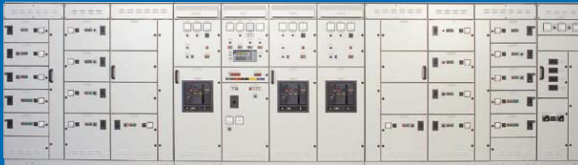
Motorsteuerung für eine offshore Anwendung mit 4 Sektionen, integrierten Anzeigen, Startern und Verteilung
